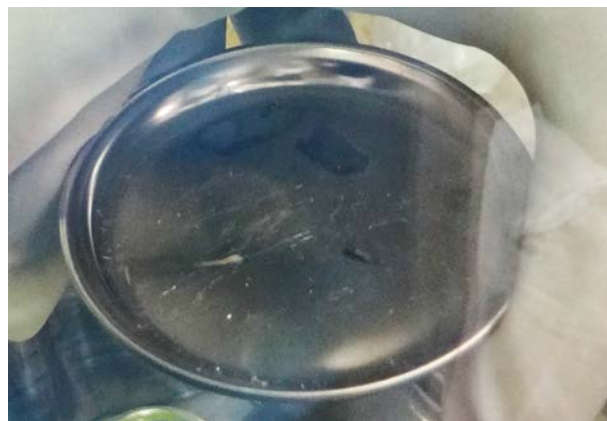
フード内養生シート上から回収・集約した飛散物 (H29. 8. 3撮影)
